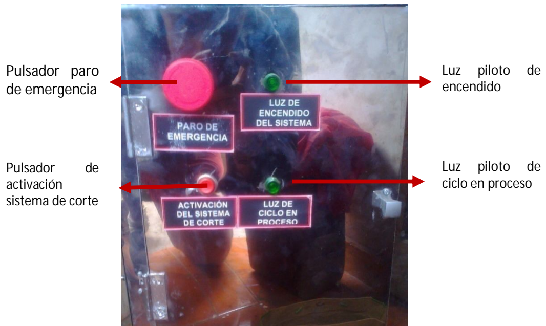
Figura 60. Vista externa del gabinete del tablero de control
