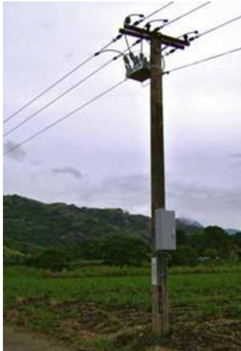
Figura N° 2 Reconectador y cubículo de control
