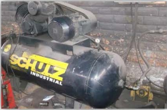
VISTA GENERAL DEL COMPRESOR
