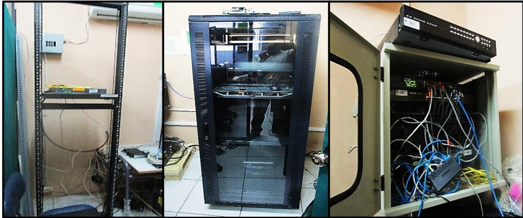
Figura 9: Racks del cuarto de telecomunicaciones
