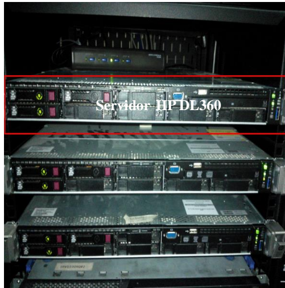
Figura 23. Servidor HP DL360 Gen9 E5-2630v3 Base SAS Svr Referencia: Datacenter FICA
