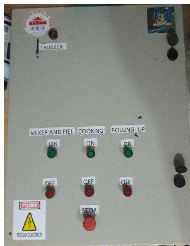
Figura 46: Tablero de control de la línea de producción de obleas
