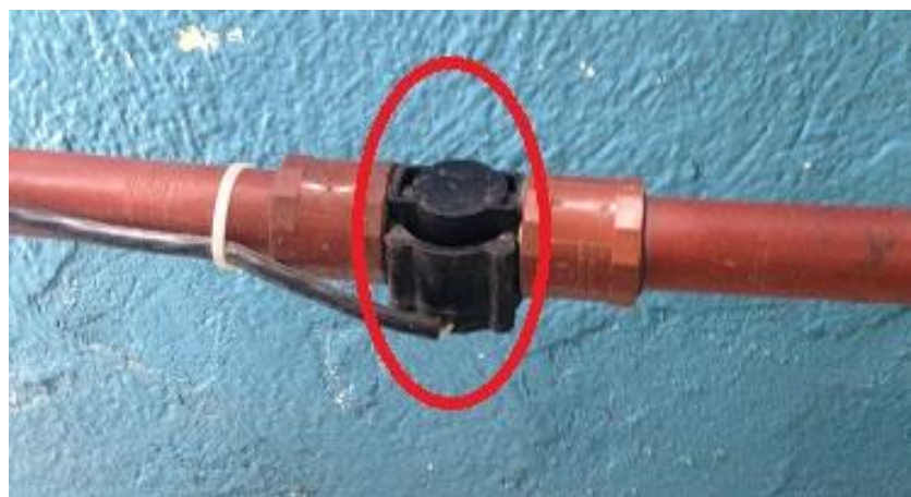
Fig. 32 Medidor de caudal mediante pulsos
