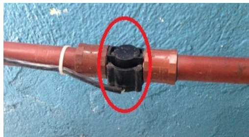
Fig.9.27 Medidor de caudal mediante pulsos
