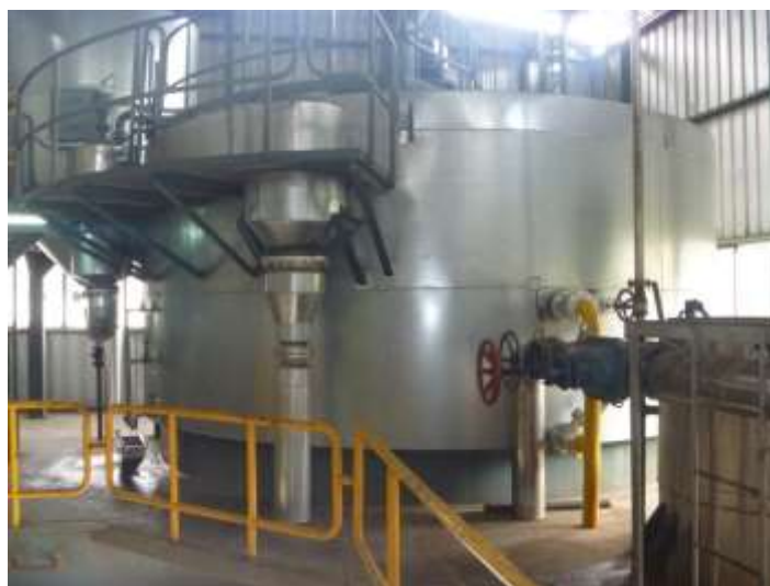
Figura 16 Área clarificación- pre- evaporador. El Autor
