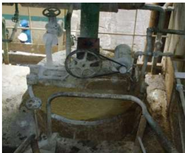
Figura 14 Área de clarificación- alcalización y filtros. El Autor
