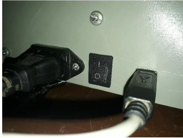
Figura 1. Tablero de encendido y conexión de la máquina
