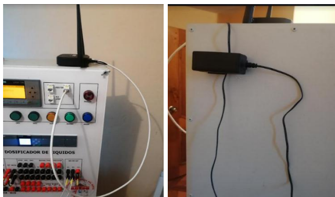
Fig. 94 Conexión router Fuente: El Autor
