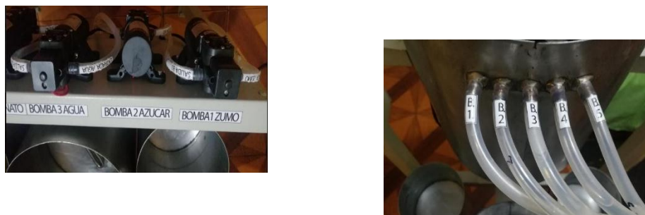
Fig. 55 Etiquetado de la parte hidráulica Fuente: El Autor
