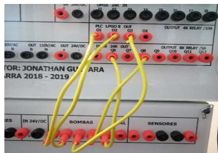
Fig. 61 Conexión Bombas Fuente: El Autor
