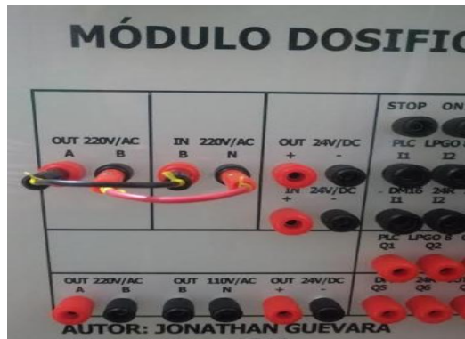
Fig. 58 Alimentacion fuente de poder 220 Vac
