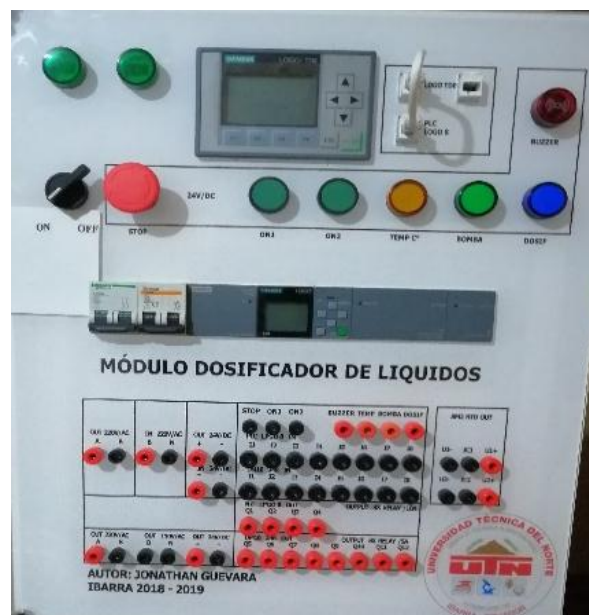
Fig. 49. Señalización del tablero principal
