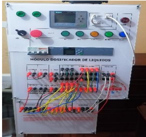
Fig. 47 Tablero de control.
