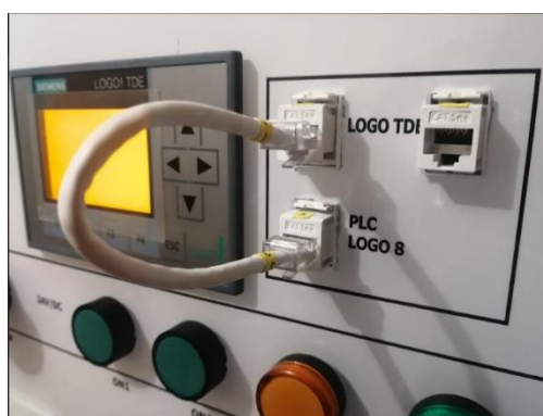
Fig. 95 Conexión pantalla TDE - PLC Fuente: El Autor
