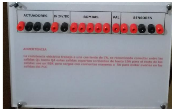
Fig. 50 Señalización del tablero secundario
