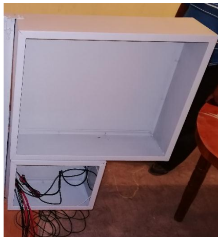
Fig. 45. Tableros del Control Fuente: El Autor
