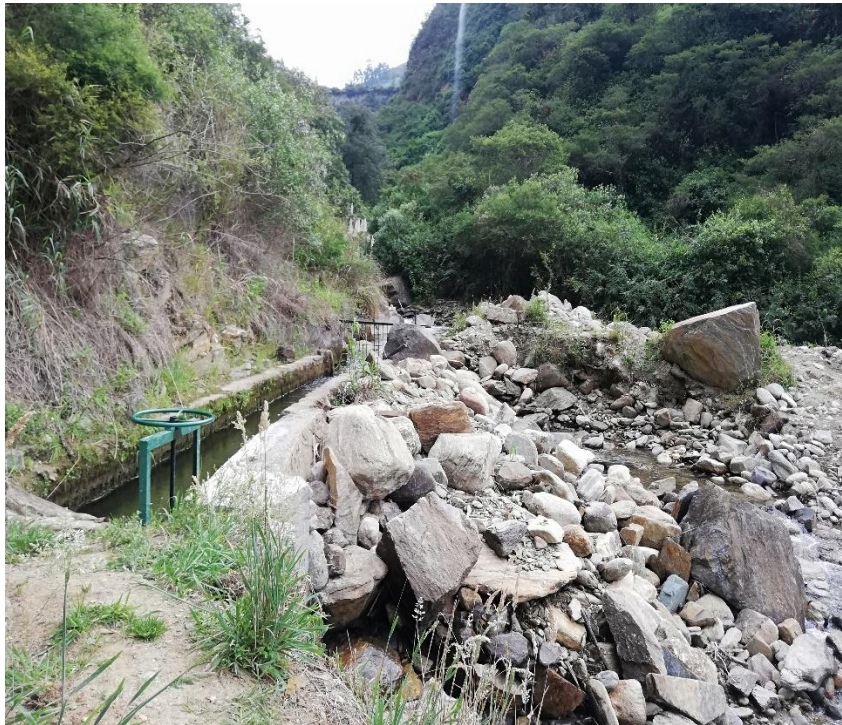
Figura 48. Captación del canal bajo Monte Olivo - San Rafael.
