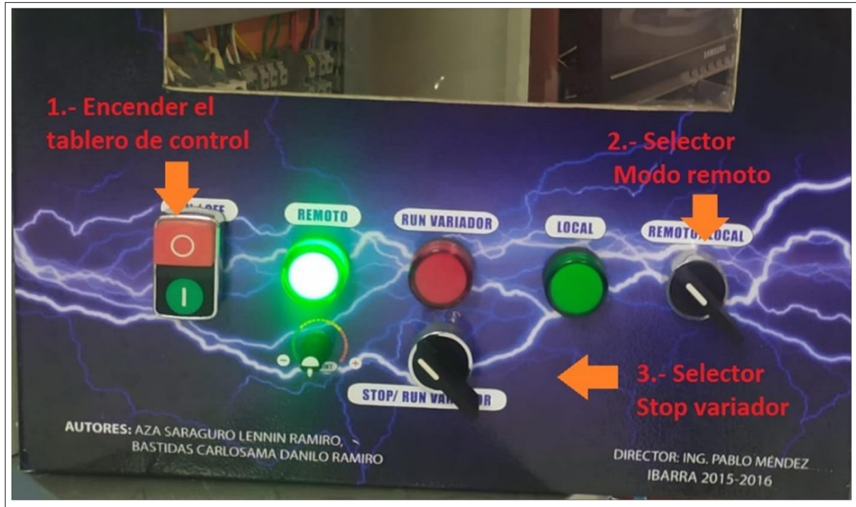
Fig. 62 Configuración del tablero de control
