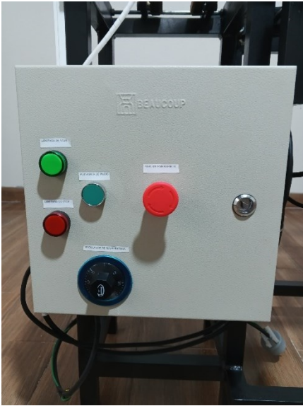
Figura 65 Puerta del armario eléctrico
