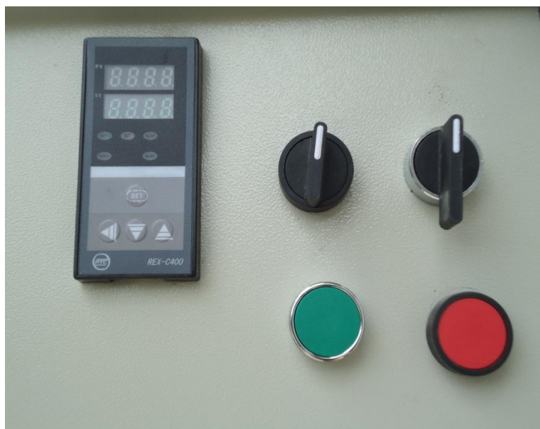
Mandos de tablero de control
