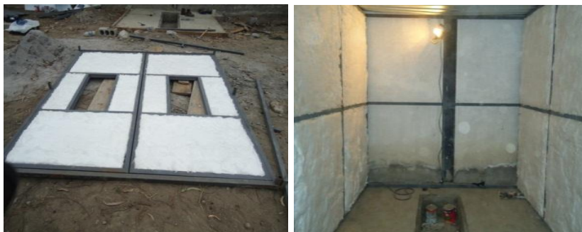
Fig. N°56 Aislamiento Térmico dentro de las paredes y compuertas de la cabina
