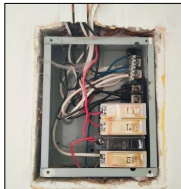
Fig. 20 Tablero de distribución principal para camerinos
