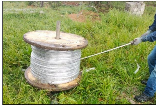
Fig. 7 Bobina de Cable ASCR 1/0.
