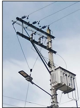
Fig. 33 Seccionador portafusible SPT-3S100 en estructura 3VR.
