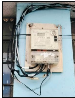
Fig. 19 Medidor bifásico electrónico del estadio
