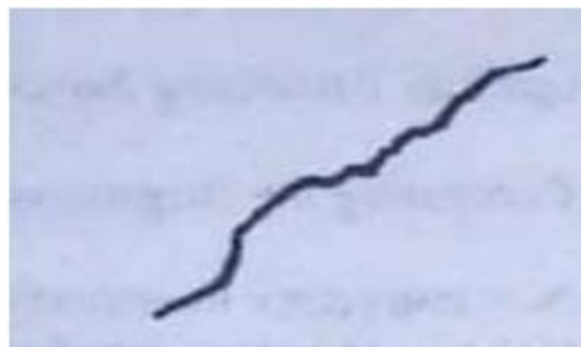
Figura 14 Visualización Fisura Lineal
