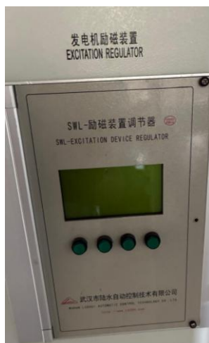
Figura 7 Regulador de Excitación del grupo generador G3
