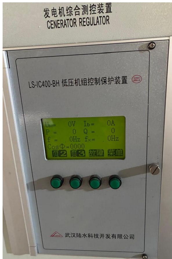
Figura 10 Sistema de protección del grupo generador G3
