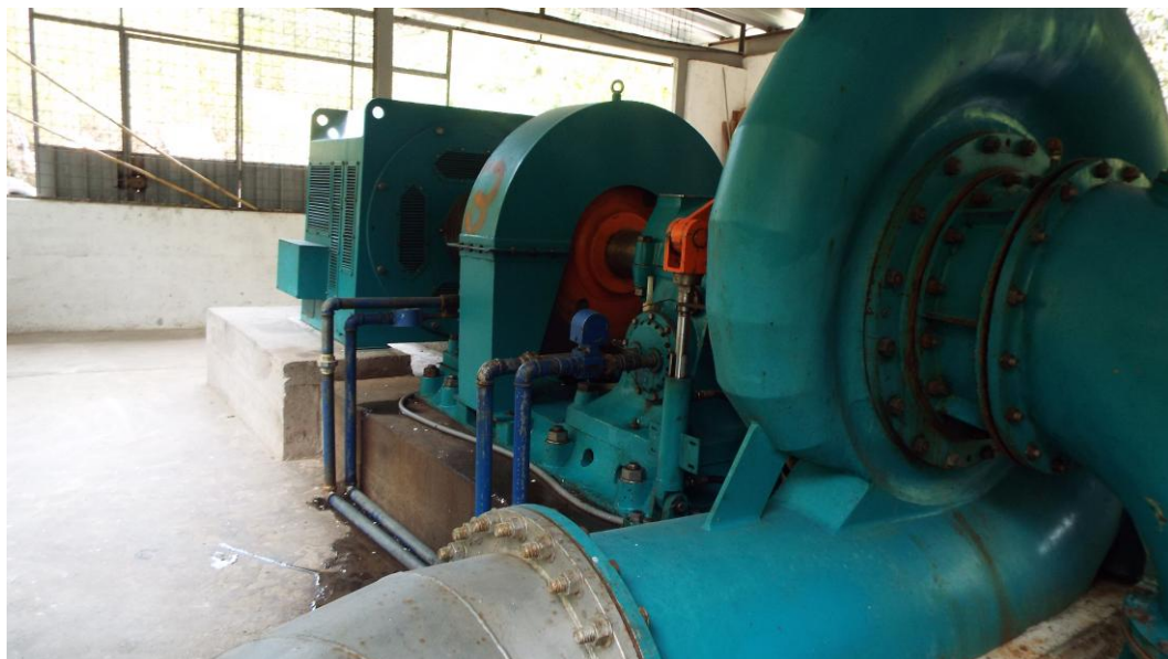
Figura 5 Generador Síncrono del grupo G3 de HidroImbabura
