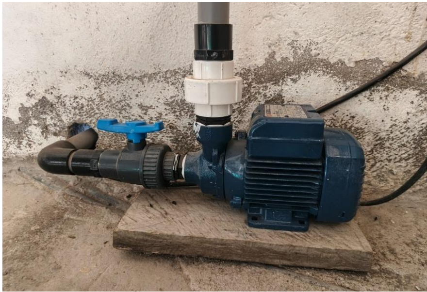
Figura 58 Bomba de Agua de 1/2 hp
