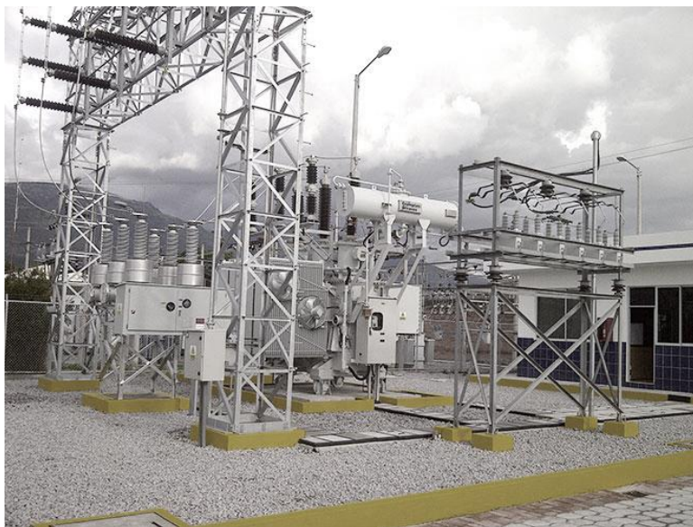
Fig. 3 Subestación San Agustín
