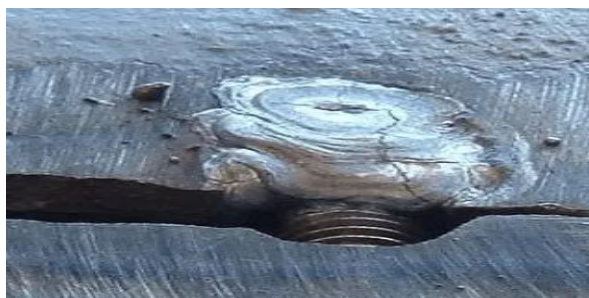
Figura 21. Grieta en forma de estrella
