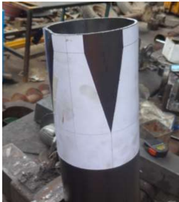
FIGURA 33: Señalización del tubo de la camisa de la cámara de combustión.
