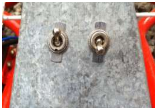
FIGURA 81: Encendido motor eléctrico.
