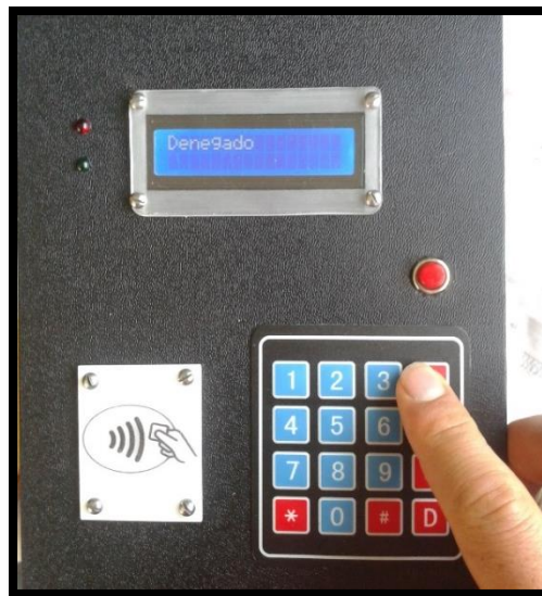
Figura 102: Ingreso de clave incorrecta mediante teclado matricial.
